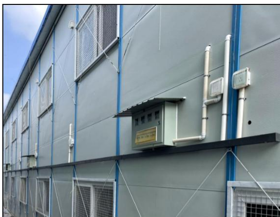
空调专用线路
